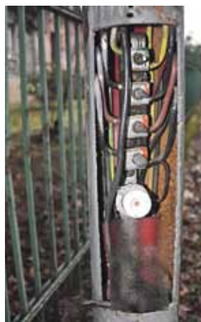
Zloději elektřiny nejčastěji zasahují do neměřených částí elektrických rozvodů nebo manipuluji přímo s elektroměry.
